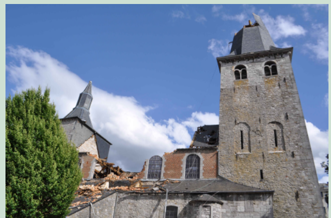
Collégiale de Ciney dévastée par le passage de la tempête du 14 juillet 2010.
